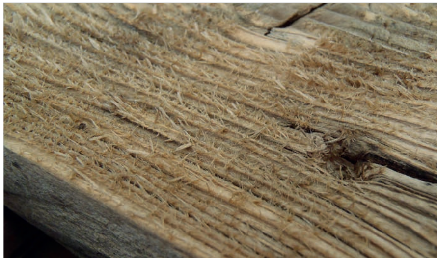
Aufgeraute Holzoberfläche nach Hochdruckreinigung mit zu geringem Abstand
