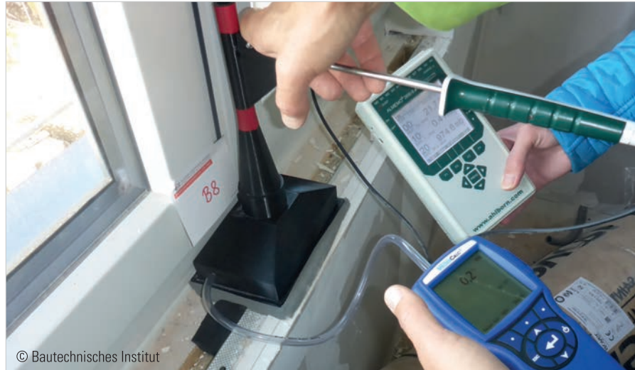
Baustellenmessung einer örtlichen Leckage im Bereich der Installationsebene mit der mobilen Messsonde
