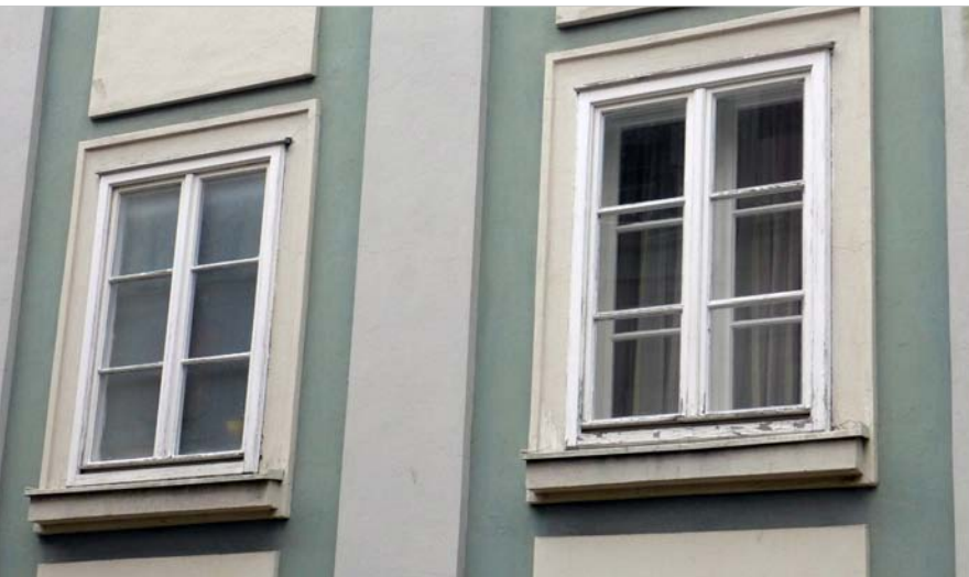
Die Holzforschung Austria wird gerne zur Beurteilung von Altfenstern herangezogen, um Sanierungsmöglichkeiten zu erarbeiten
